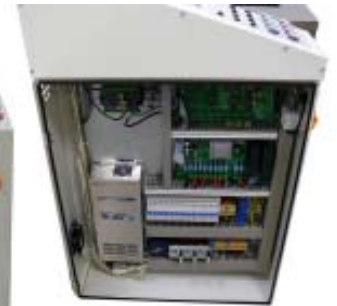
Armoire de commande
